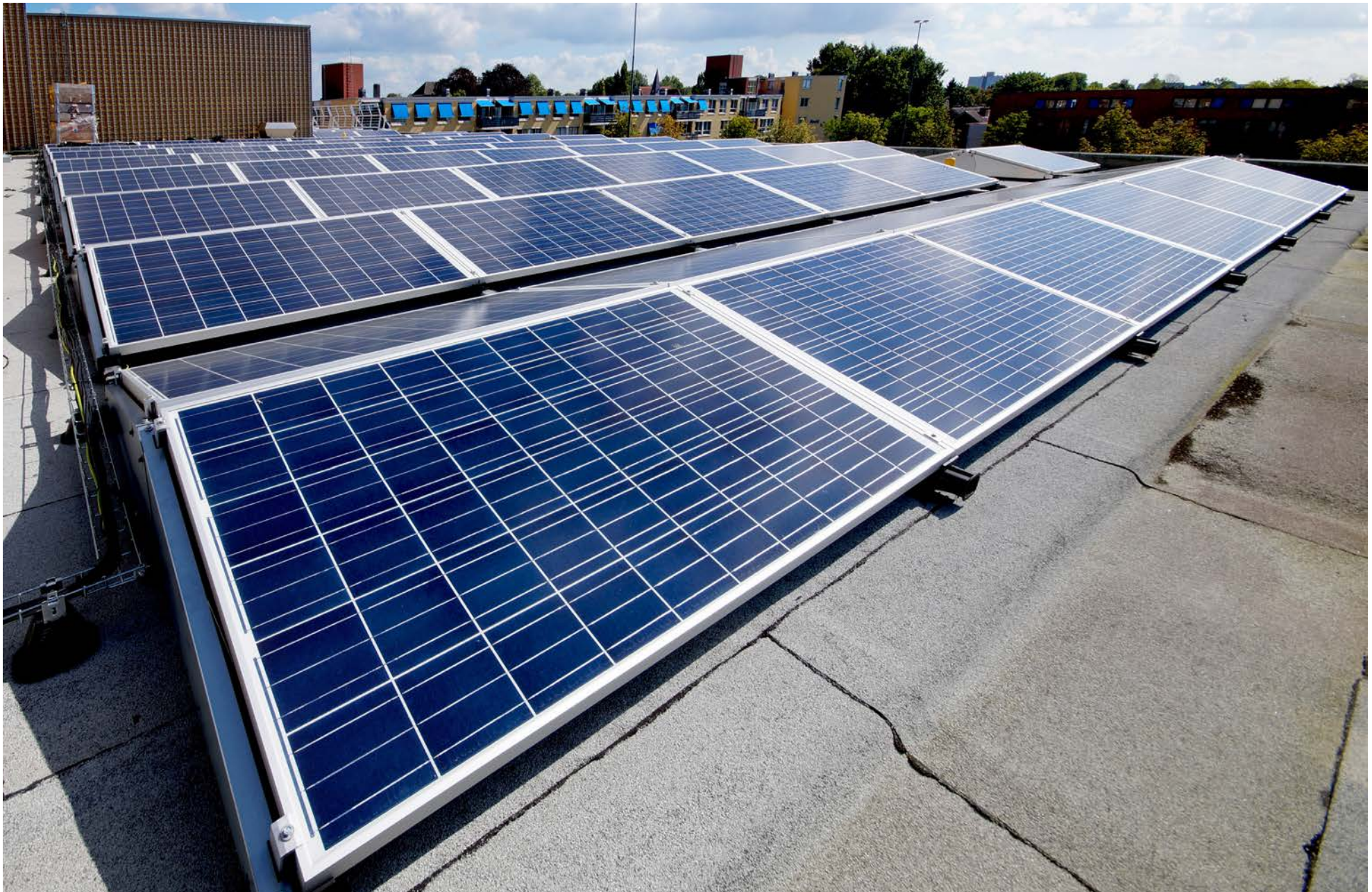
Zonnepanelen op dak van de Lawei
